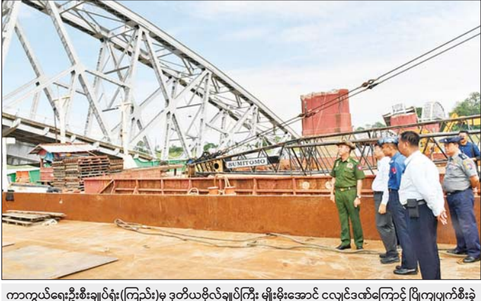
ကာကွယ်ရေးဦးစီးချုပ်ရုံး(ကြည်း)မှ ဒုတိယဗိုလ်ချုပ်ကြီး မျိုးမိုးအောင် ငလျင်ဒဏ်ကြောင့် ပြိုကျပျက်စီးခဲ့သော အင်းဝတံတား၌ မြန်မာစီးပွားရေးကော်ပိုရေးရှင်း(MEC)မှ တာဝန်ယူဆောင်ရွက်နေသော နူးအမှတ် ၄/၅ တွင် အပျက်အစီးများ ဖယ်ရှားရှင်းလင်းခြင်းလုပ်ငန်း ဆောင်ရွက်နေမှုကို ကြည့်ရှုစဉ်။
