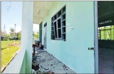
Drone ကျရောက်ပေါက်ကွဲမှုကြောင့် အခြေခံပညာအထက်တန်းကျောင်း(ခွဲ)အောင်စေယျာရှိ စာသင်ဆောင်များ ပျက်စီးခဲ့မှုကို တွေ့ရစဉ်။
