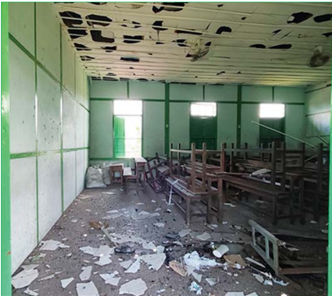
Drone ကျရောက်ပေါက်ကွဲမှုကြောင့် အခြေခံပညာအထက်တန်းကျောင်း(ခွဲ)အောင်ဇေယျရှိ စာသင်ဆောင် များ ပျက်စီးခဲ့မှုကို တွေ့ရစဉ်။
