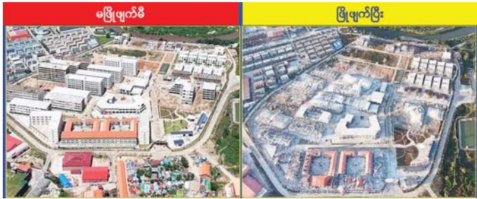
KK Park နယ်မြေ အပိုင်း(၂)အား ဖောက်ခွဲဖျက်ဆီး ဖြိုချထားရှိမှုကို တွေ့ရစဉ်။
