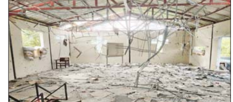
လေးကွေ့ကော်မြို့သစ်ရှိ ဌာနဆိုင်ရာအဆောက်အအုံများအား အကြမ်းဖက်သမားများက ဖျက်ဆီးခဲ့သည့် မှတ်တမ်းဓာတ်ပုံ။
