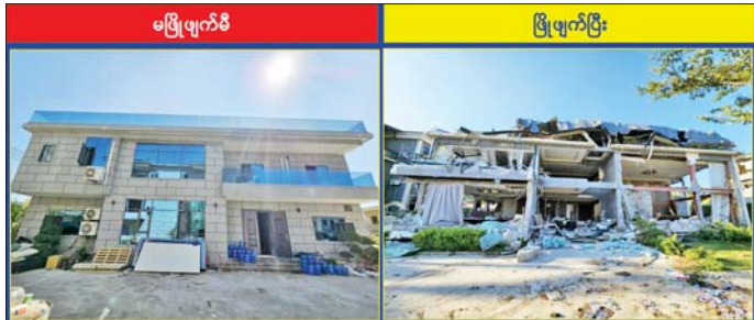
KK Park နယ်မြေအပိုင်း(၂)တွင် တရားမဝင်ဆောက်လုပ်ထားသည့် နှစ်ထပ်လူနေအဆောက်အအုံအား မဖြိုဖျက်မီနှင့် ဖြိုဖျက်ပြီး တွေ့ရစဉ်။
